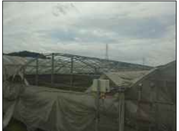
台風により破損したビニルハウスの被覆資材
