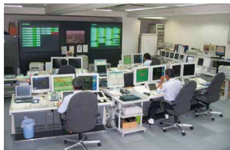
消防緊急情報システム
