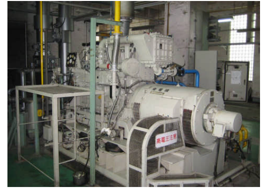
図4 宮崎処理場既存消化ガス発電機
