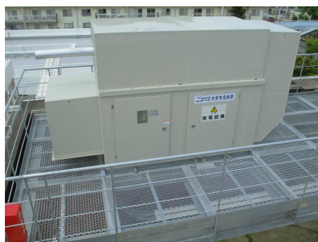
非常電源 （自家発電設備）
