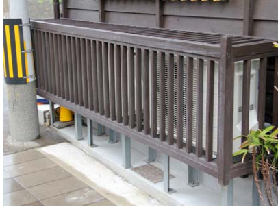
空調室外機を木格子で遮蔽した事例
