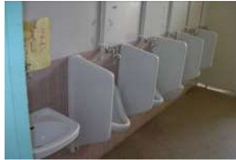
老朽化したトイレ
