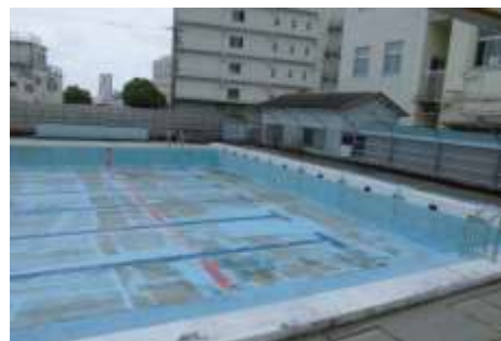
老朽化したプール水槽
