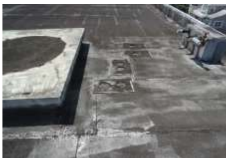
老朽化した屋上防水
