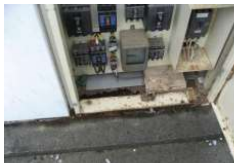
老朽化した高圧受変電設備
