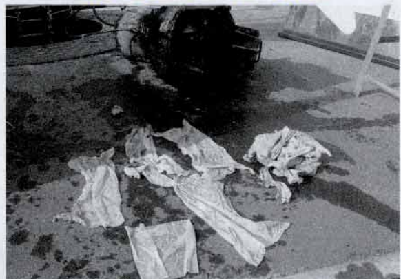
詰まっていたペーパータオル
