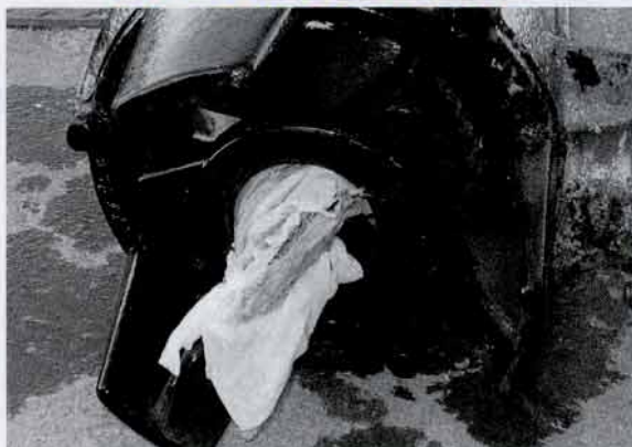
詰まって動かなくなったポンプ
