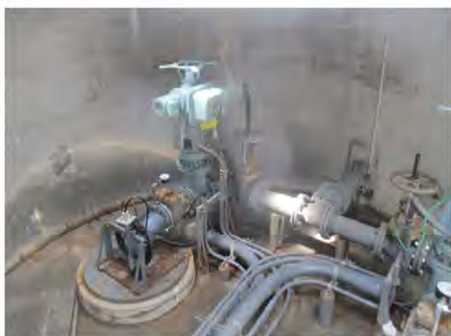
【ポンプピット内の配管状況】
