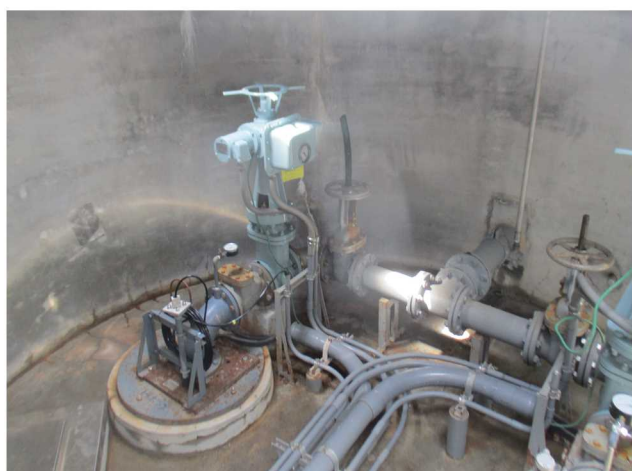
【ポンプピット内の配管状況】
