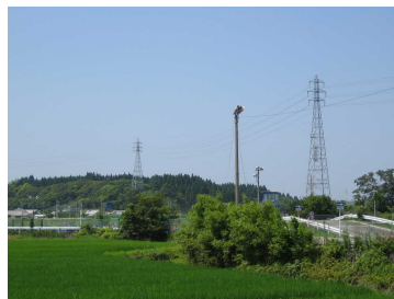
高圧線の鉄塔
