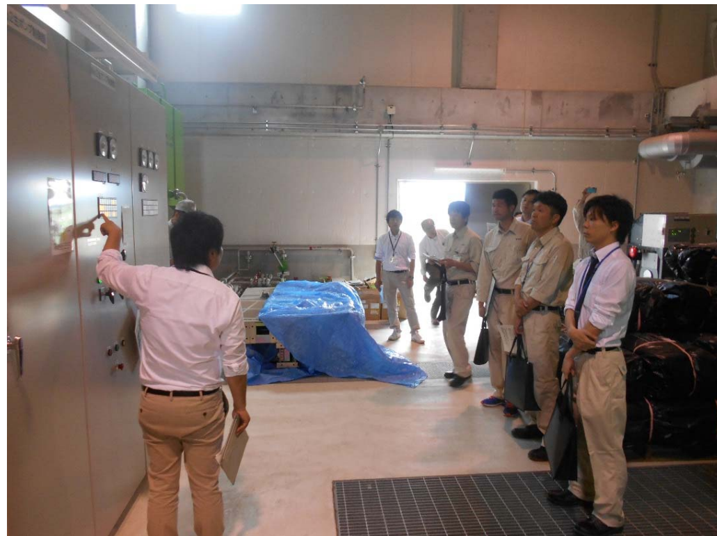
合同操作訓練（瓜生野川排水機場）
