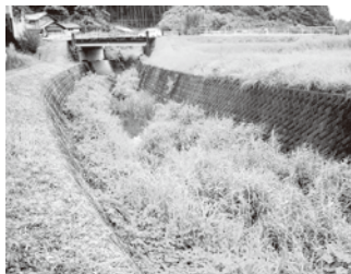
北川内川の堆積土砂に生えた雑草 （北川内橋付近）
