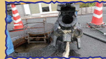
マンホールポンプに異物が詰まった状態
