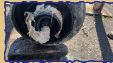
マンホールポンプのスクリュー部分写真
