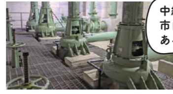
中継ポンプ場の内部
