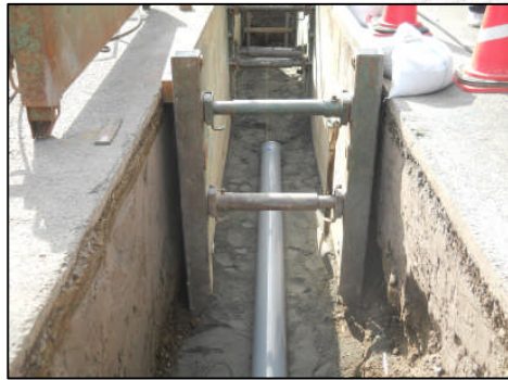
A-3-2 木原処理分区面整備(未普及解消) C-3-1 木原処理分区枝線整備
