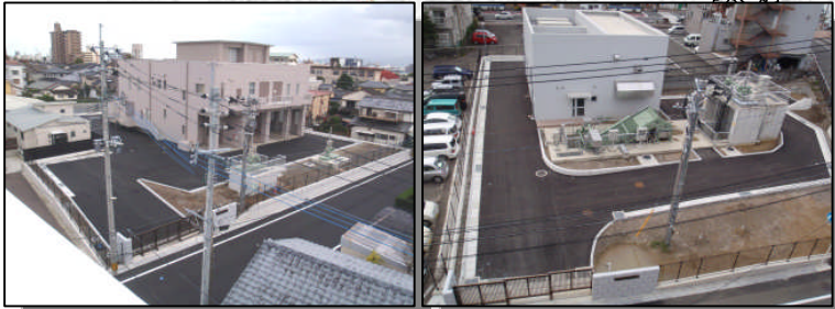
淀川雨水ポンプ場
