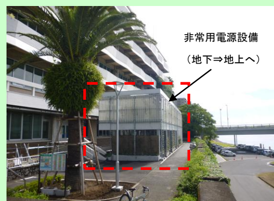
◆行政庁舎の防災機能強化（宮崎市役所：非常用電源設備の整備）
