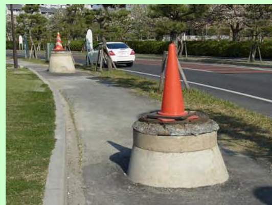
◆液状化によるマンホールの浮上がり（浦安市資料：浦安市HPより）
