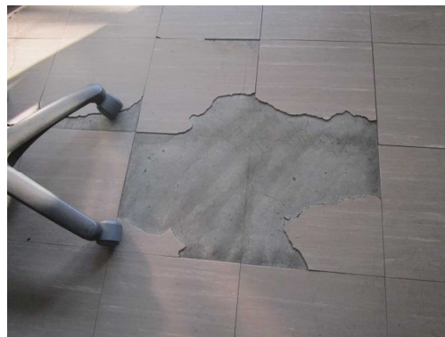
建物内部も老朽化が激しい
