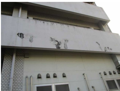
外壁の剥離が数多く見られる
