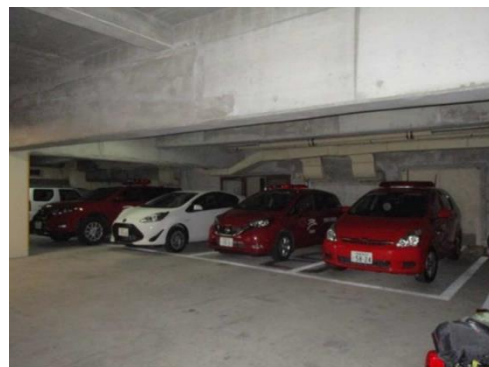
・地下駐車場は天井が低く、狭い ・大雨時にエレベーターピットが浸水したことがある
