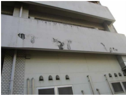
外壁の剥離が数多く見られる
