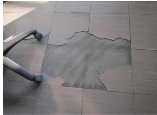
建物内部も老朽化が激しい
