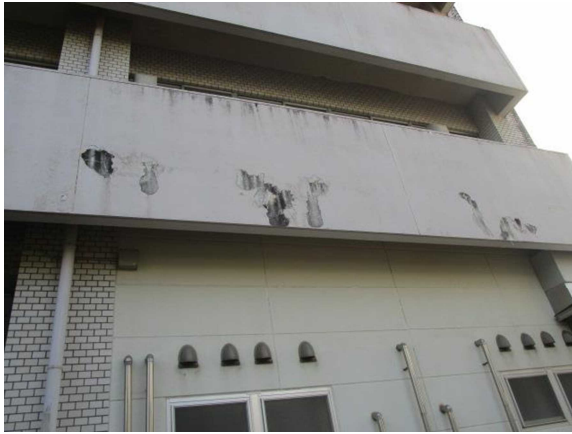
外壁の剥離が数多く見られる
