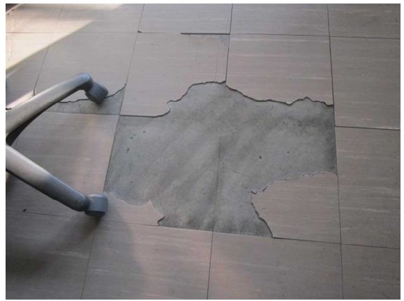
建物内部も老朽化が激しい
