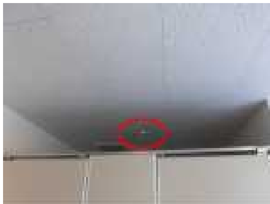
照明器具と天井の間隙間
