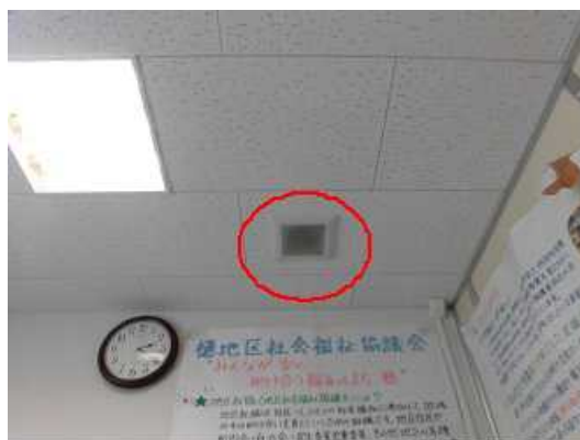
換気口の雨漏りの状況
