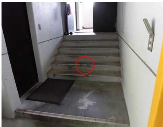
階段（車庫） ノンスリップタイルの破損
