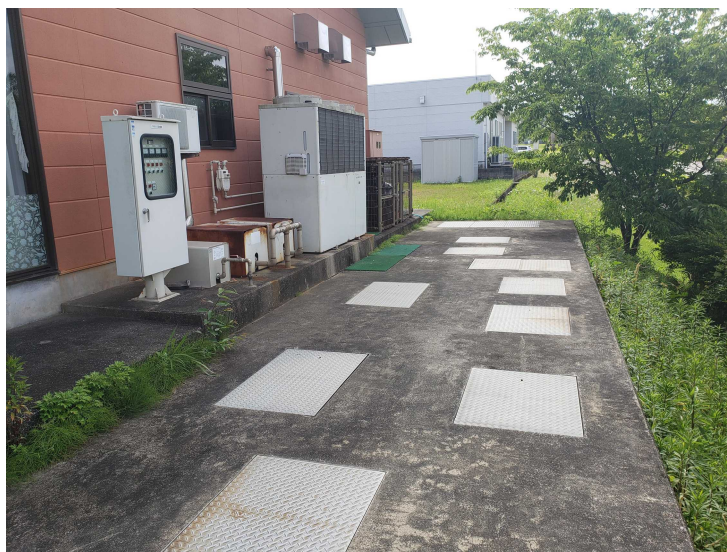
浄化槽の内部配管等の劣化
