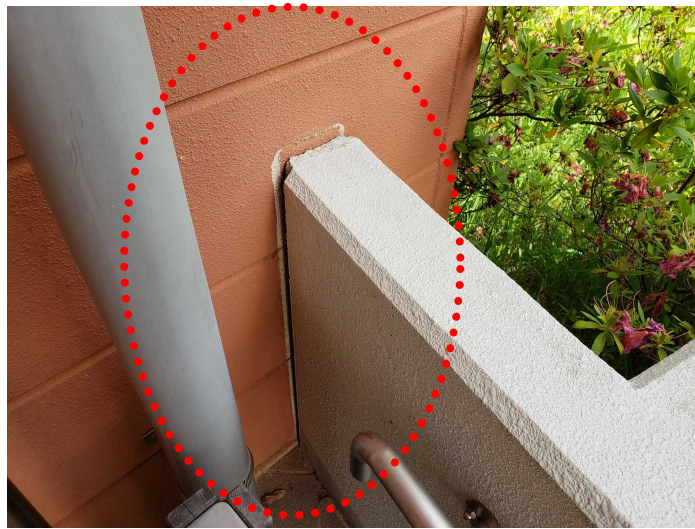
地盤沈下の形跡
