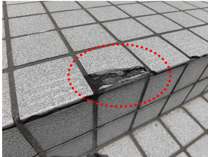
玄関の踏段ノンスリップタイルの欠損
