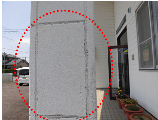
目地シーリング材の劣化、ひび割れ
