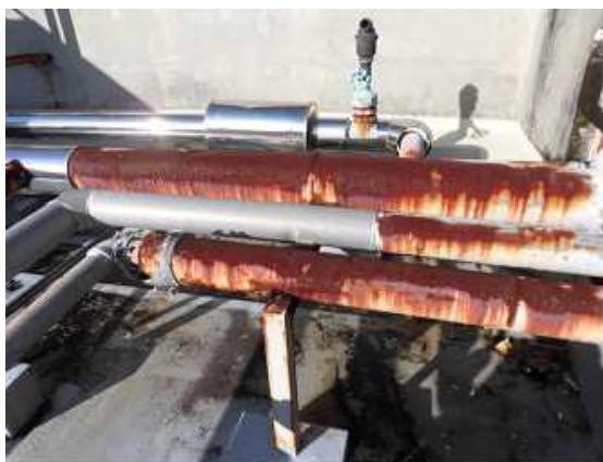
屋上の配管の状況
