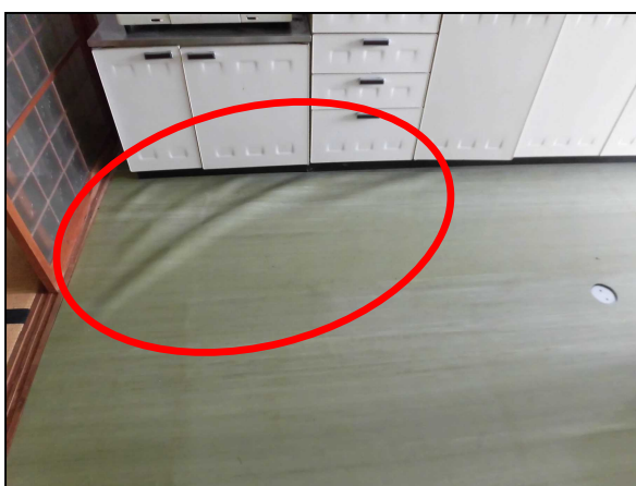
床シートに浮き
