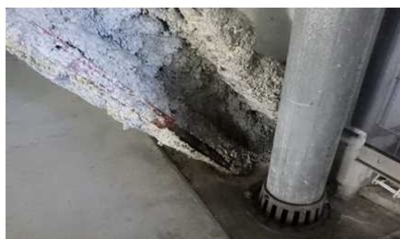
耐火被覆・塗装（剥落、鉄骨の錆）
