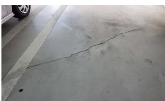
床版（ひび割れ）
