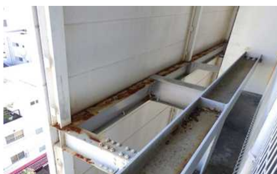
塗装（錆の発生）
