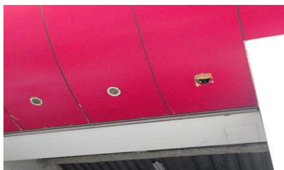
出入口上部照明（一部破損）
