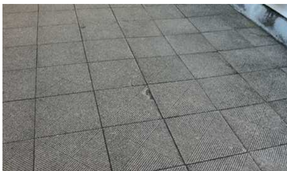
1階通路タイルブロック（割れ欠ける）
