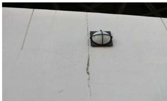
外壁（吹きつけタイルの割れ）
