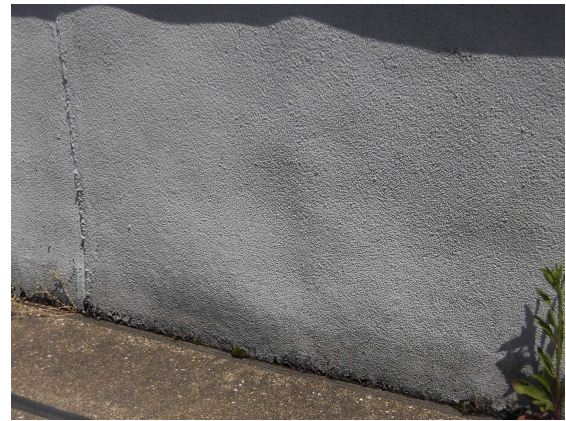
劣化部分拡大
