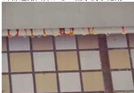
外部通路天井からの漏水及び発錆
