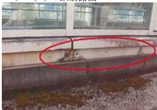
パラペットの鉄筋露出
