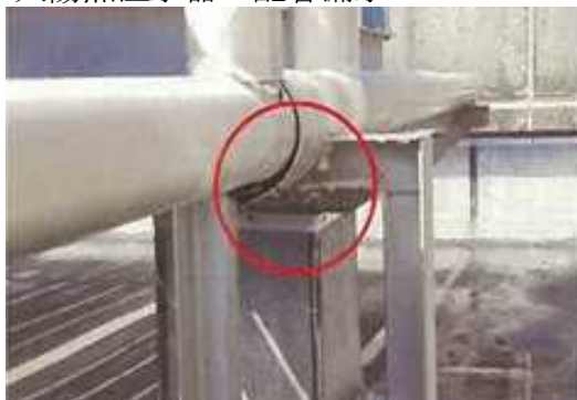
太陽熱温水器の配管漏水
