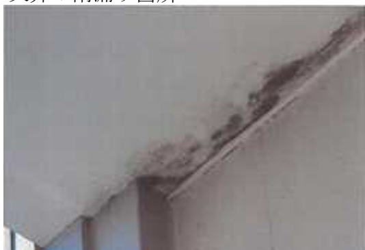
天井の雨漏り箇所
