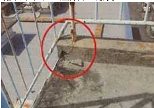
階段手すりの柱脚部の爆裂
