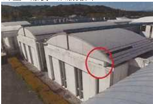
外壁の爆裂・鉄筋露出
