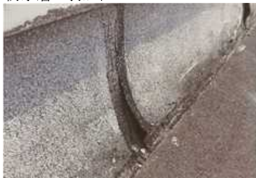
防水層の剥がれ
