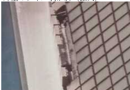
外壁のタイル剥がれ (拡大)
