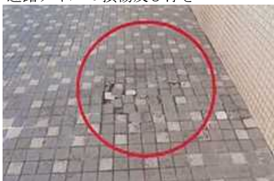
通路タイルの損傷及び浮き
