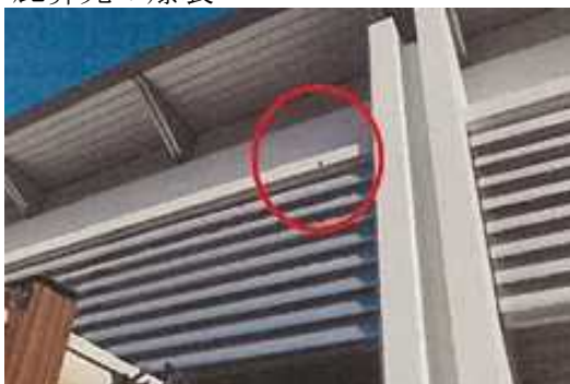
庇鼻先の爆裂
