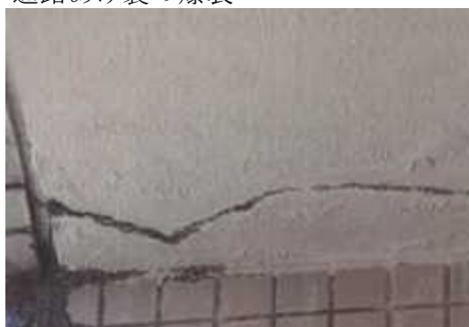
通路あげ裏の爆裂
