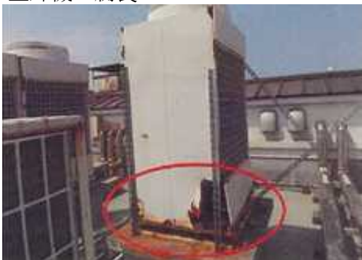
室外機の腐食
