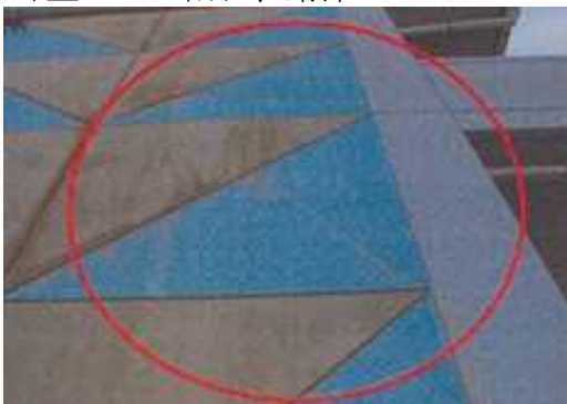
外壁のひび割れ、錆汁
