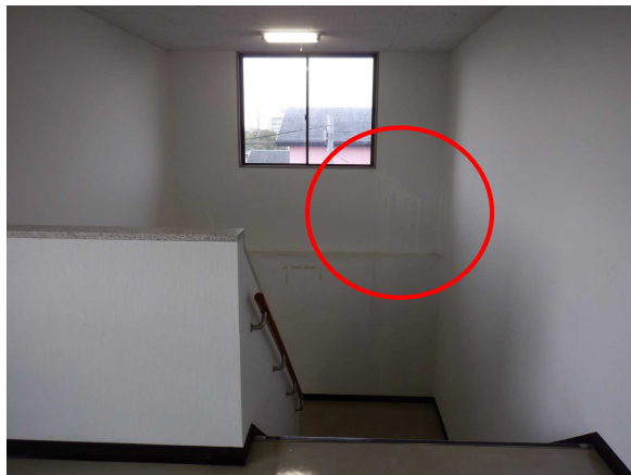
階段 階段壁の雨漏り跡
