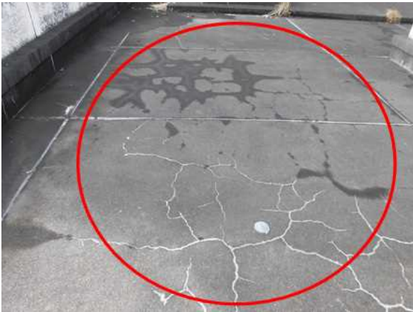
屋上面 防水保護モルタルのひび割れ及び浮き
