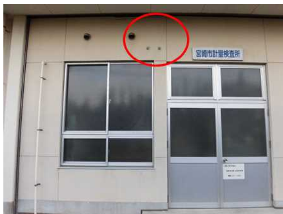
外壁 外壁のひび割れ
