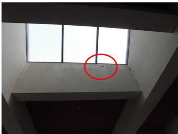
外壁 外壁の爆裂
