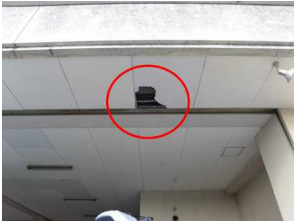
外装仕上げ材 庇あげ裏の損傷
