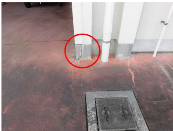
基礎 基礎巾木モルタルのひび割れ及び浮き
