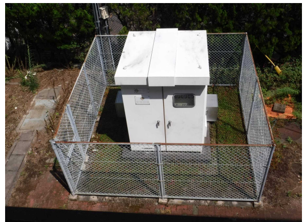
高圧受電設備
