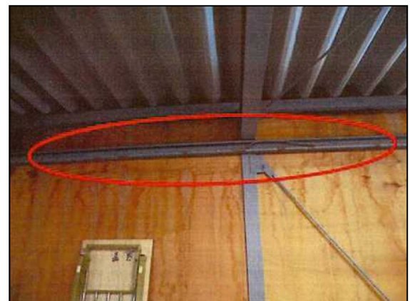
内部鉄骨の発錆状況
