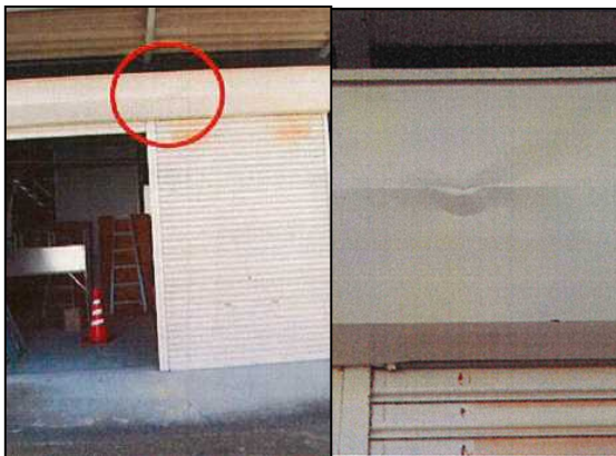
シャッター損傷の状況
