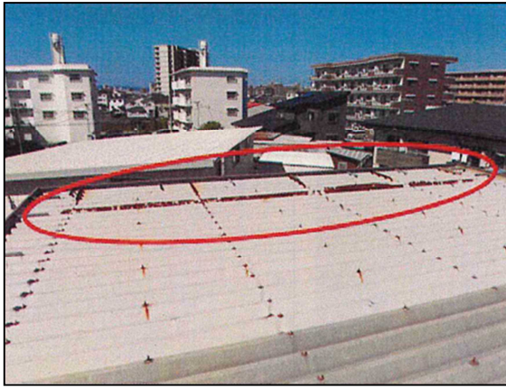
屋根材の発錆状況①
