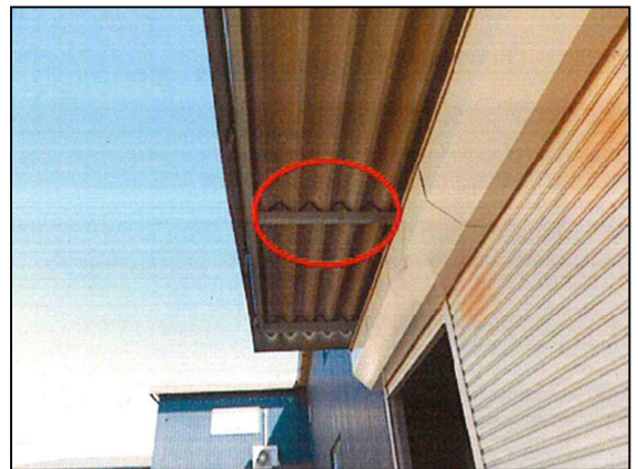
庇タイトフレームの発錆状況
