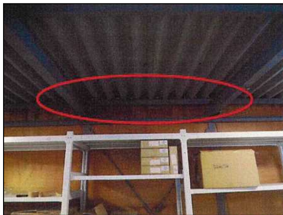
屋根面戸の隙間状況
