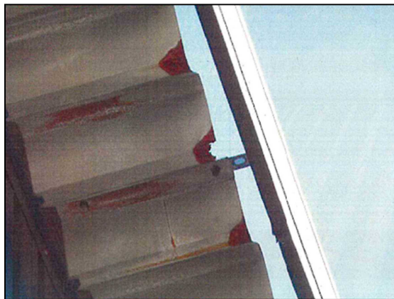
屋根材の腐食及び発錆状況③
