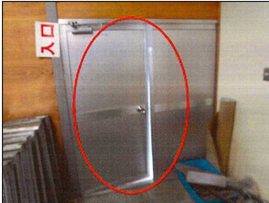
ドア変形の状況
