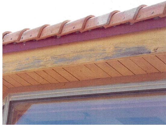
屋根木部の塗装の劣化(拡大写真)
