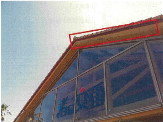
屋根木部の塗装の劣化
