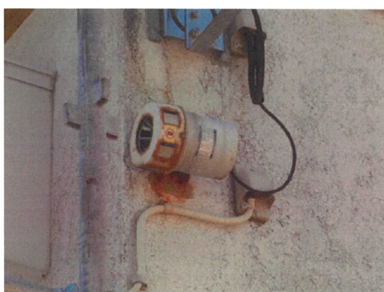
サイレンの発錆(拡大写真)
