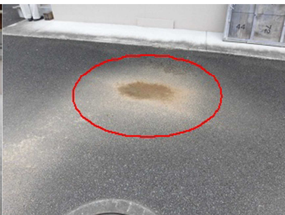
舗装の水たまり跡の状況
