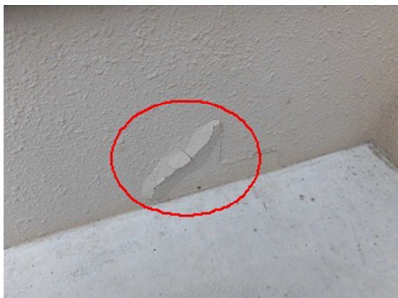
基礎の塗装劣化状況
