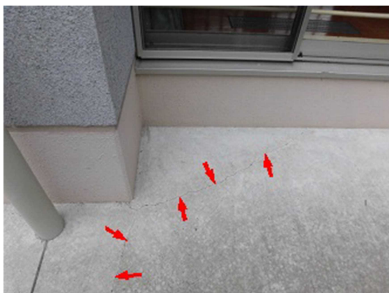
犬走りのひびの状況
