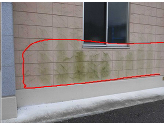
外壁の苔の付着状況
