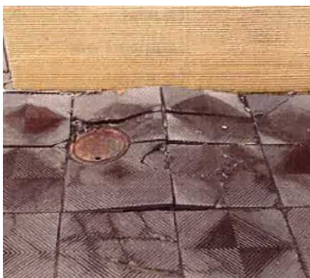
屋外タイル破損
