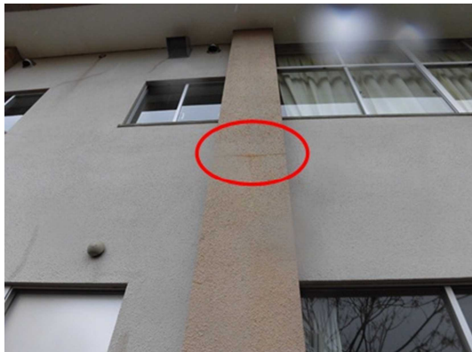
柱のひび割れ
