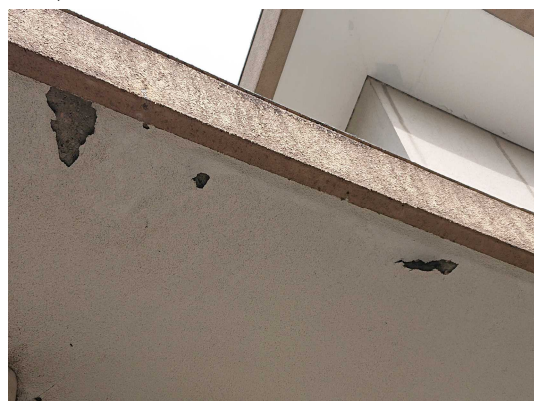
塗装の剥がれ
