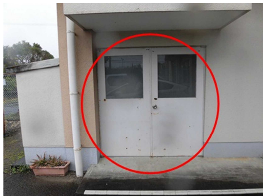
鋼製建具の発錆
