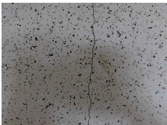
室内壁ひび割れ
