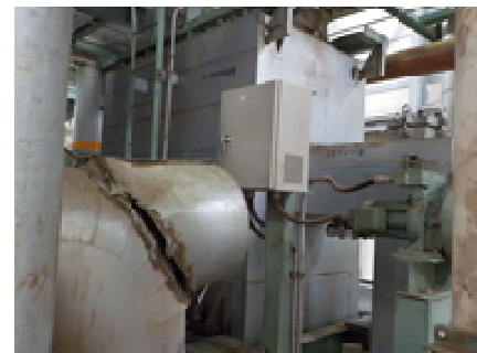
（焼却炉の老朽化の状況） 乾粉供給機の腐食状況
