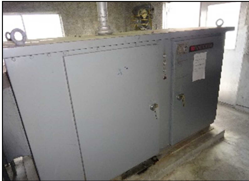
自家発電装置（恒久源藤ポンプ場）
