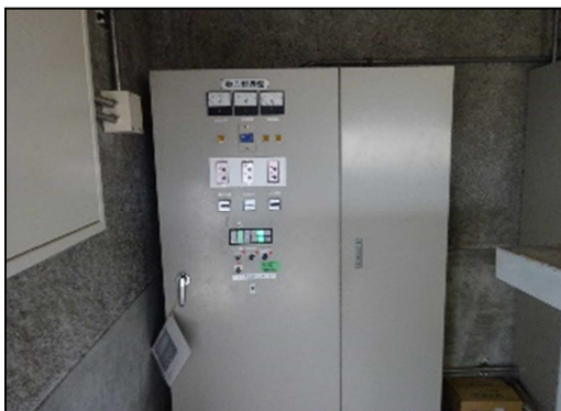
動力制御盤（恒久源藤ポンプ場）
