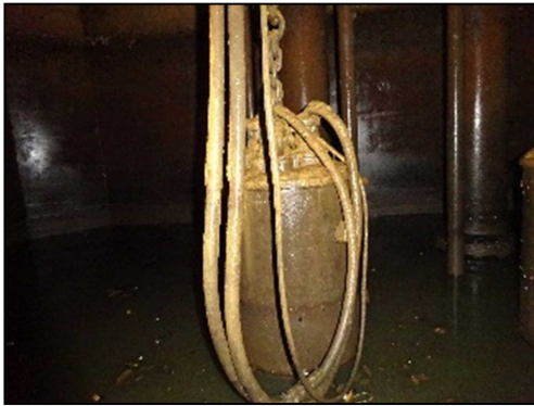
ポンプ（下北方排水機場）
