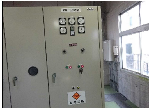
受変電設備（下北方排水機場）
