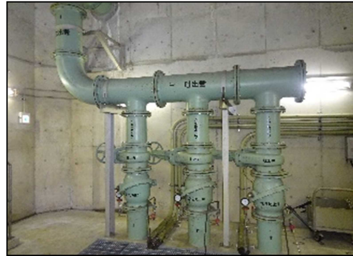
配管（下北方排水機場）
