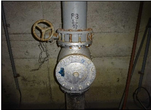
弁（恒久源藤ポンプ場）
