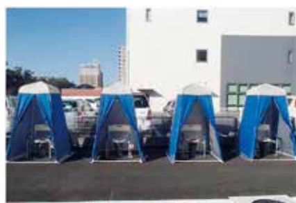
マンホールトイレ (地震・津波などの災害発生時の活用)
