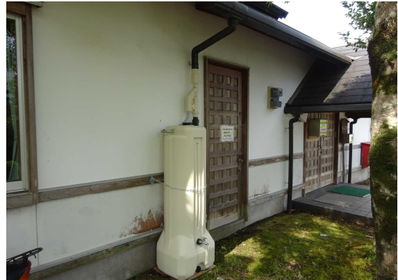
非常時に備え、生目台6自治公民館に雨水を貯めておくタンクを設置しました。
