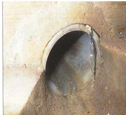
（管口から浸入水の発生）
