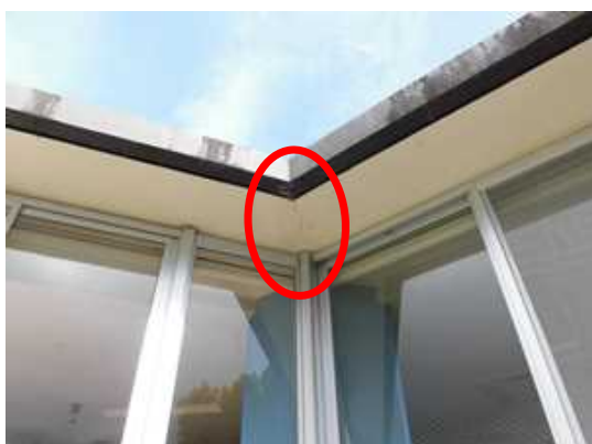
【建物西側】 あげ裏ひび割れ、白華
