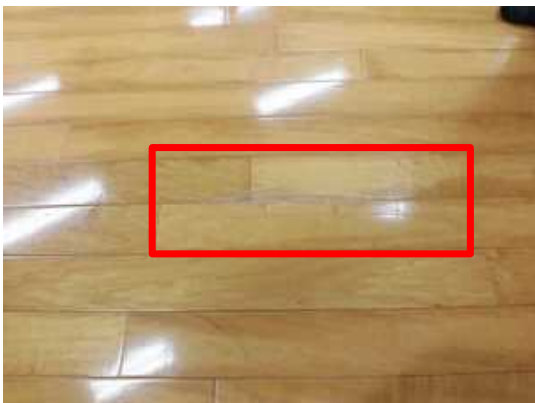
[1階 集会室兼食堂] 床材ひび割れ
