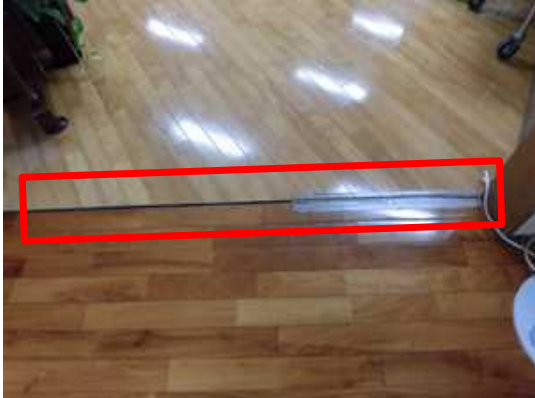
[1階 集会室兼食堂] 床段差
