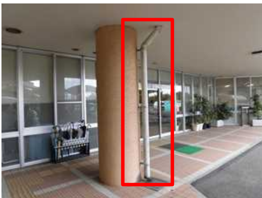
[建物南側] 壁樋塗装劣化、発錆
