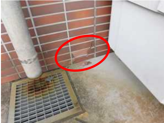
[建物北側] 壁タイルひび割れ、剥がれ
