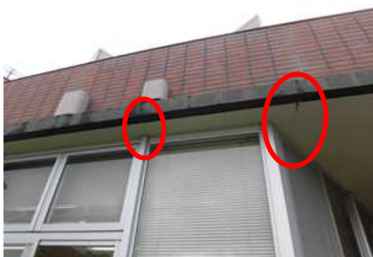
[建物西側] あげ裏ひび割れ、白華
