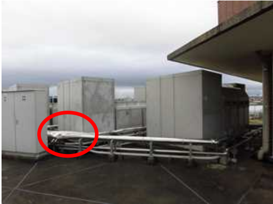
[屋上1] 配管ラッキング変形
