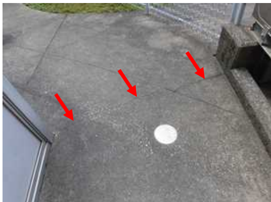
[北側通路] 通路ひび割れ
