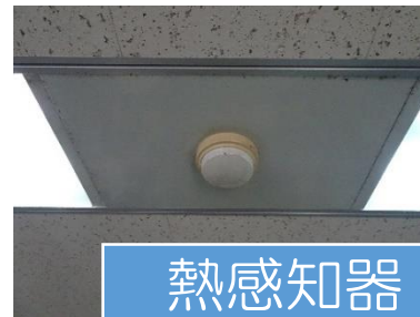
自動火災報知設備（感知器）
