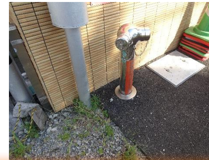
連結送水管設備
