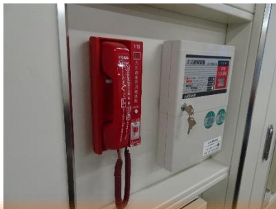
消防機関へ通報する火災報知設備
