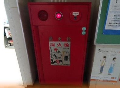
屋内消火栓設備
