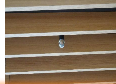
スプリンクラー設備
