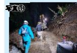
国道38号被災状況
