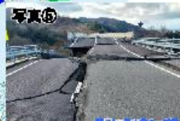
国道249号被災状況
