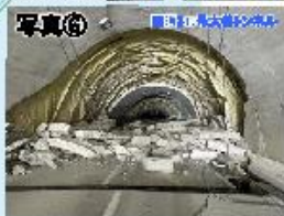
国道249号被災状況
