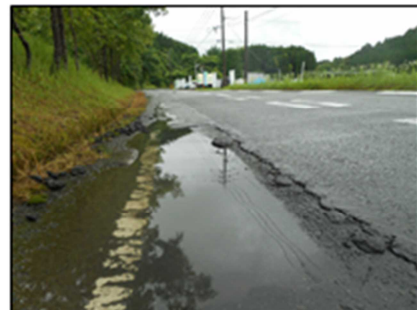
写真 4-2 わだち掘れ状況
