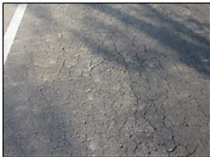
写真 4-1 ひび割れ状況
