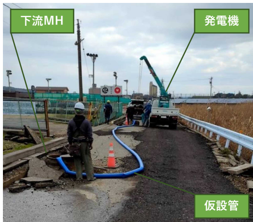
令和6年能登半島地震(七尾市)
