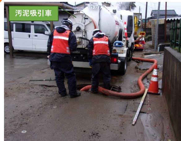
令和6年能登半島地震(内灘町)
