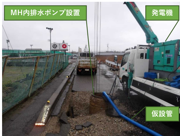
令和6年能登半島地震(七尾市)
