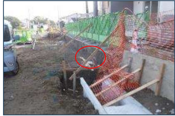
歩道路床一部崩壊箇所
