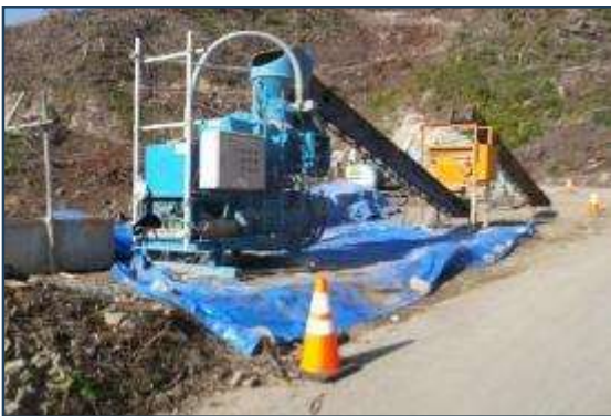
モルタルプラント
