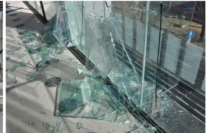
震災当日の外壁ガラスのようす(外壁の損傷)
