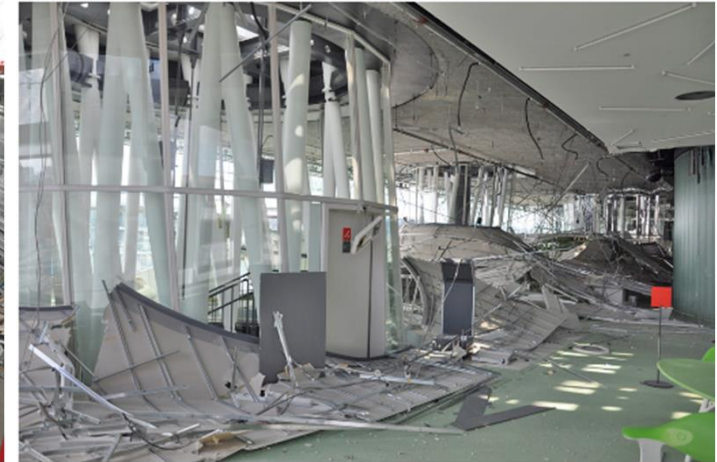
震災当日の7階スタジオのようす(天井の落下)
