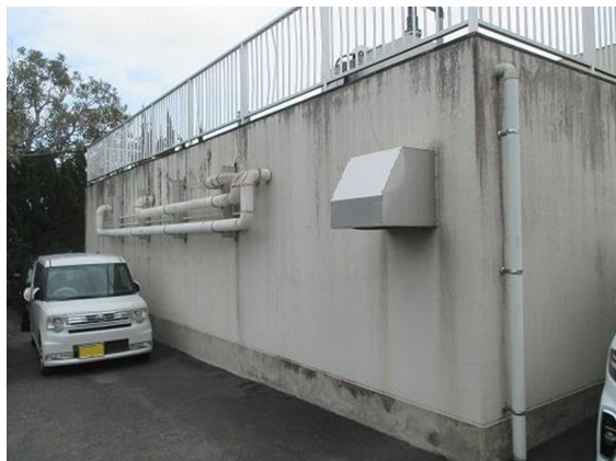
排水処理施設の老朽化
