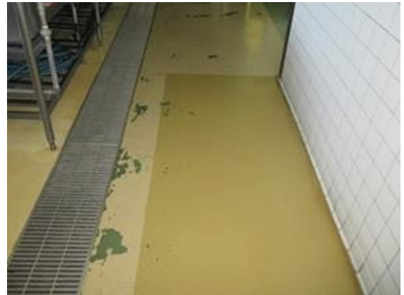
調理室床の塗装剥れ
