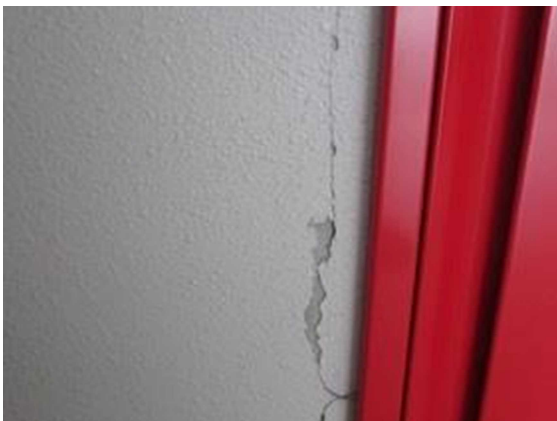
内部仕上の破損
