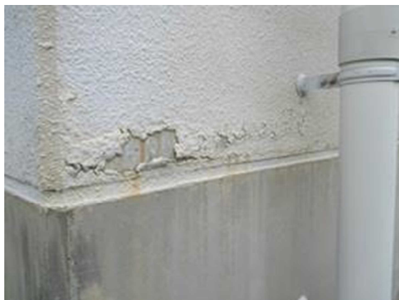
外壁の塗装剥れ
