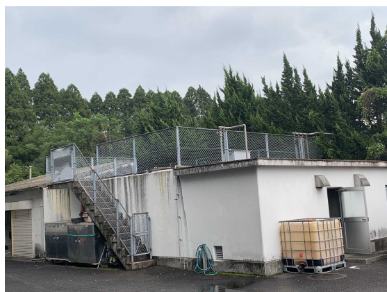
排水処理施設の老朽化
