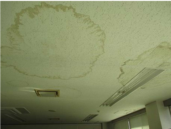
過去の漏水による天井汚れ
