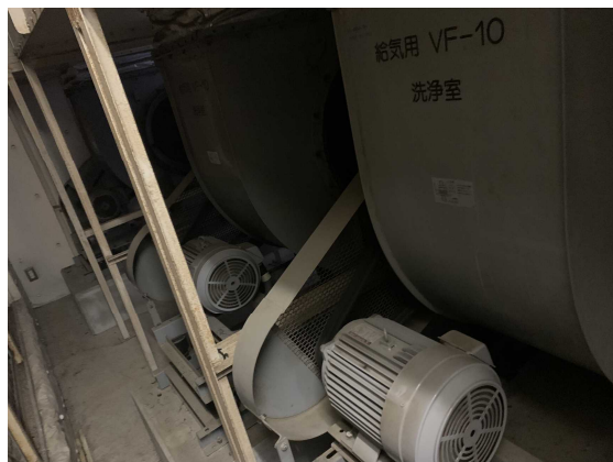
給排気設備の老朽化
