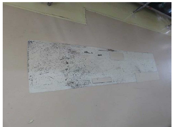
調理室床の塗装剥れ
