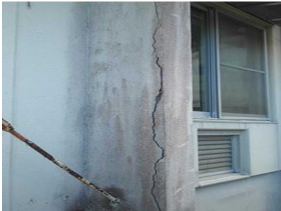
外壁のひび割れ
