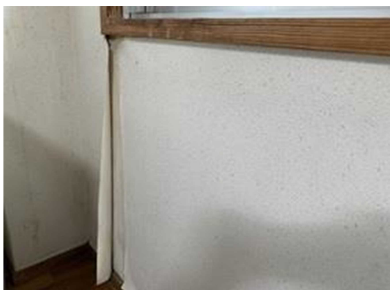
内部仕上材の剥れ
