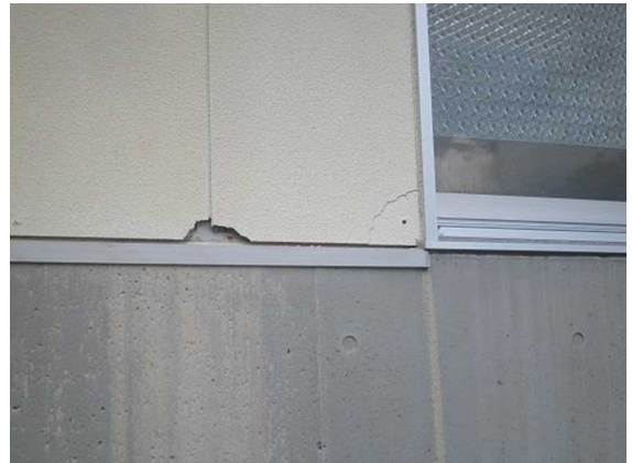
外壁材の割れ
