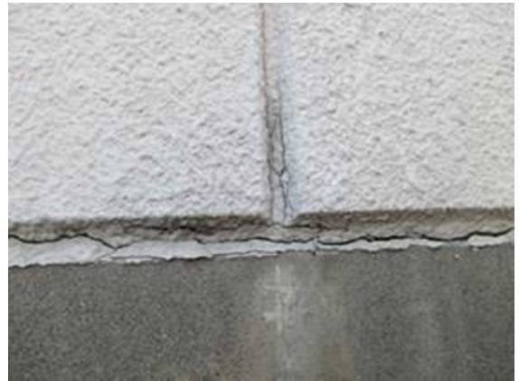
外壁コーキング材の劣化
