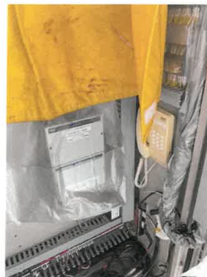
図 I-3 制御盤内部の状況
