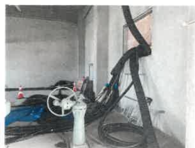
図Ⅲ-6 配水室の状況
