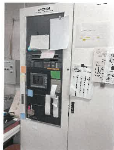
図Ⅱ-4 更新前の非常放送設備
