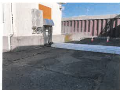
図Ⅲ-2 電気供給室から
