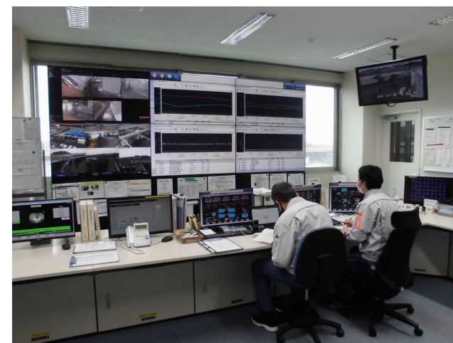
運転管理業務の様子 （富吉浄水場中央監視室）
