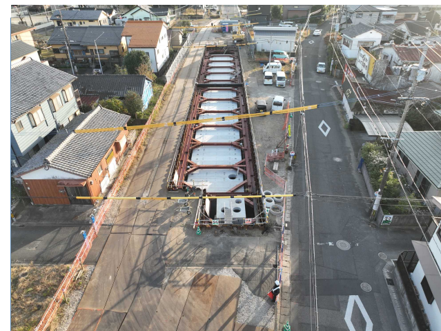
波島地区貯留管整備状況
