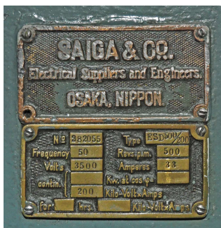
発電機に取り付けられた才賀電気商会のプレート
